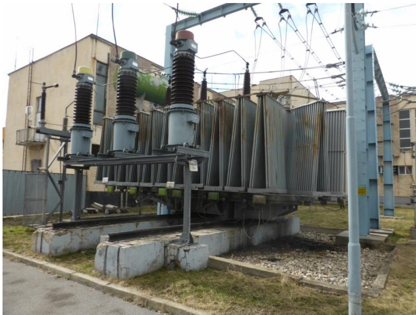
Снимка 5: Един от трансформаторите
