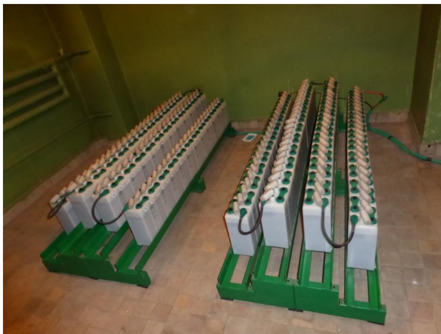
Снимка 7: Акумулаторно помещение в Подстанция на ул. „Адам Мицкевич“
