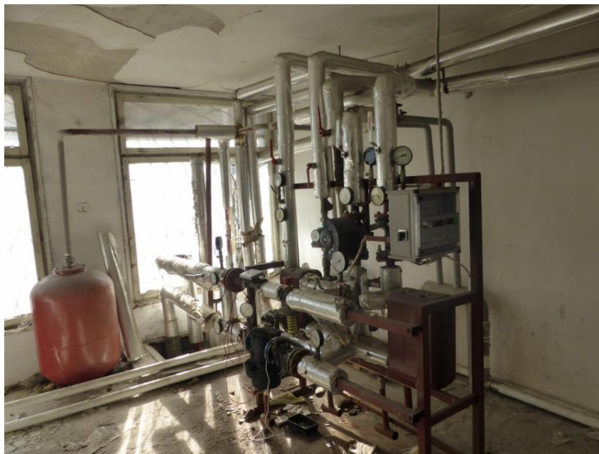
Снимка 8: Топлинен преобразовател (абонатна станция) в сградата на ул. „Добринова скала”
